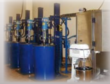
STATION DE PRÉPARATION des encres : Pompes de transfert sur élévateurs monocolumnes
